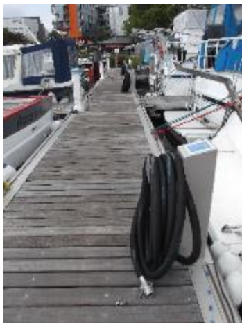
Exemple de potelet et tuyau d'aspiration
